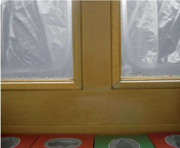
Bild 5 Ein raumseitiger Tauwasserausfall am Übergang Glas zum Rahmen kann durch den Einsatz von Gläsern mit der „warmen Kante“ reduziert werden. Fotoquelle: © ift Rosenheim
